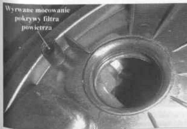
Fot. 6.15. Wyrwane mocowanie pokrywy z obudowy filtra powietrza
